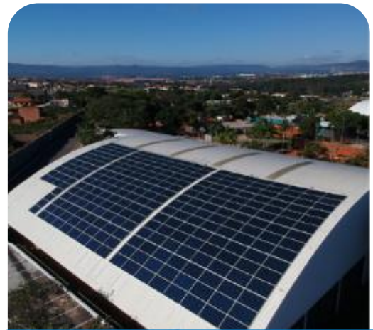
Sistema solar instalado pela EGSD
