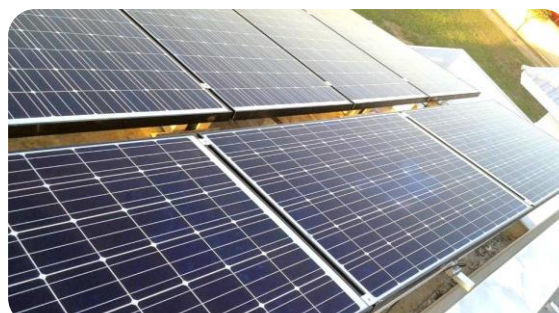
Sistema solar instalado pela EGSD
